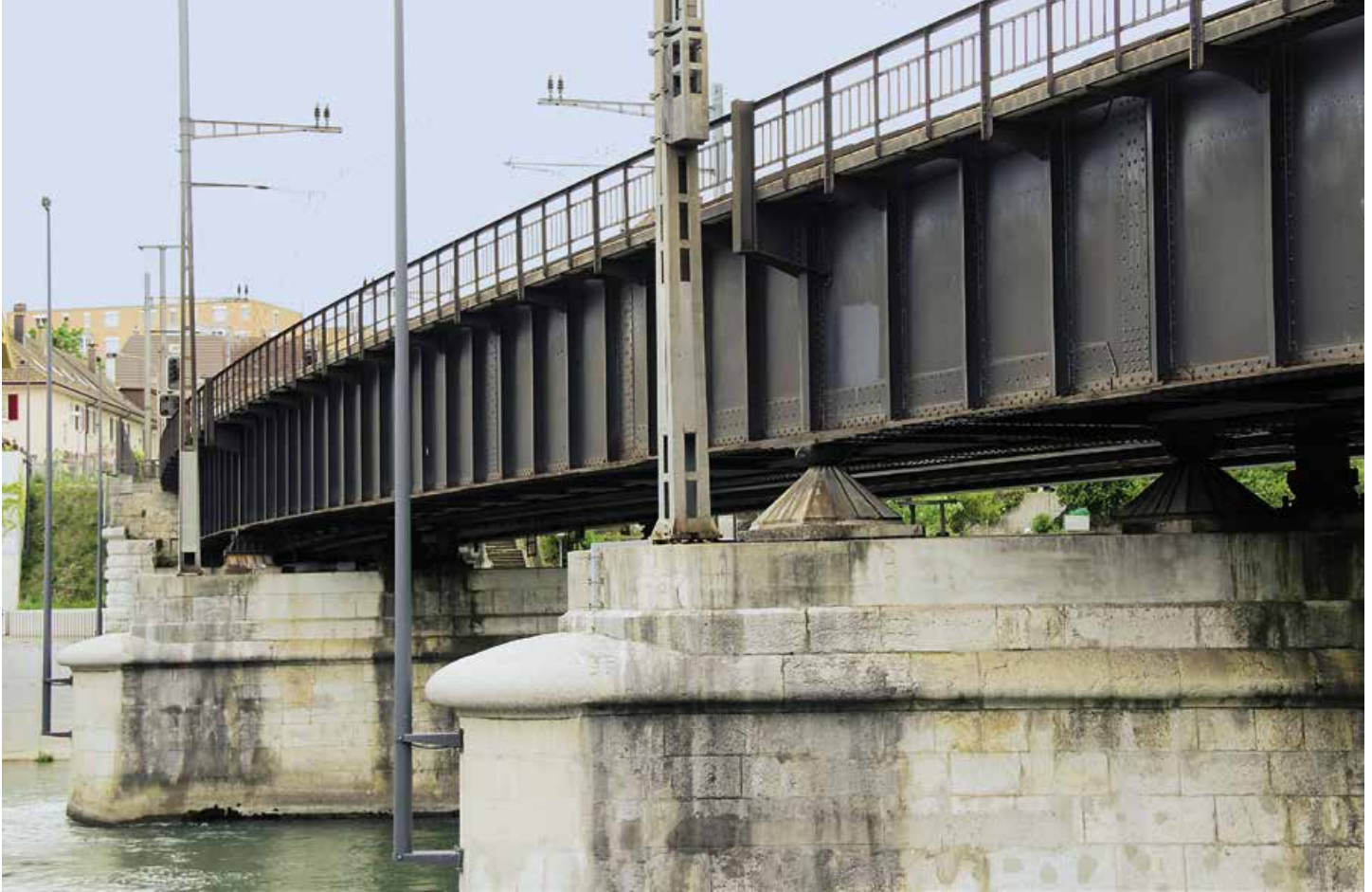
1 Die Aarebrücke der Gäubahn mitten im städtischen Umfeld von Olten ist vor allem aus bautechnischer Sicht wertvoll: Sie war 1927 der erste im Grundriss gekrümmte Vollwandträger der Schweiz. 3,5
